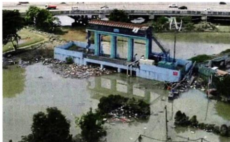
■發生水災時，水閘門的水面曾堆滿垃圾。
